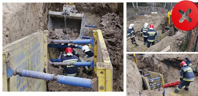
Rys. 6. Kilka zdjęć z akcji ratowniczej. Pracownik znalazł się w strefie pomiędzy boksami. Nieprawidłowy dobór obudowy doprowadził do zasypania pracownika. Błędy te w większości dotyczyły lekkich obudów, które stosowane są na znacznych głębokościach bez jakiegokolwiek weryfikacji parcia gruntu, bez uwzględnienia jakichkolwiek dobrych praktyk z dokumentacji DTR czy przepisów BHP. Za każdym razem przed przystąpieniem do prac zalecamy bezpłatne konsultacje z doradcami Koproas
