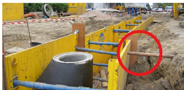
Rys. 7. Obudowy tymczasowe należy opuszczać do wykopu metodą „Tnij i obniżaj”, dzięki temu zabezpieczamy infrastrukturę towarzyszącą przed osiadaniem, osuwaniem. W pokazanym przypadku wykonawca doprowadził do rozluźnienia gruntu za obudową. Wykop powinien być obsypany
