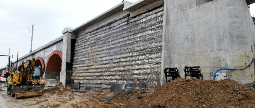
Rys. 5. Realizacja ściany oporowej z licem biernym, etap wykonania masywu zbrojonego, Kraków, linia kolejowa E30
