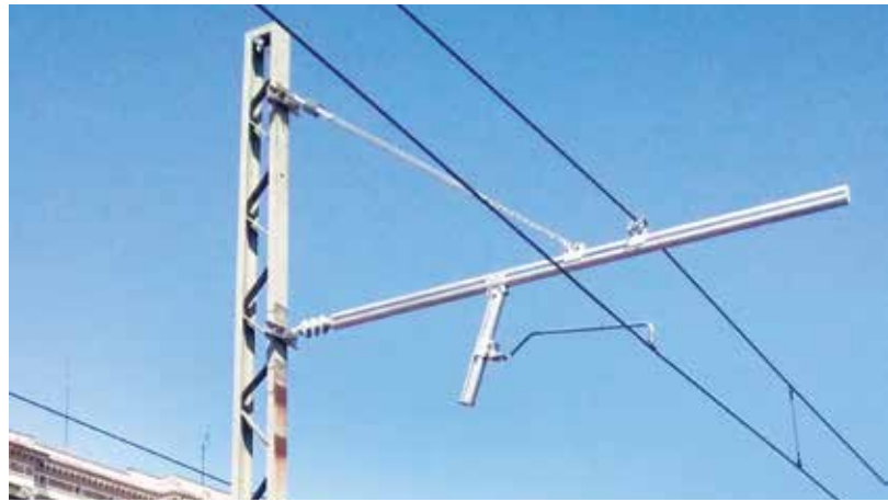
Fot. 7. Podwieszenie obniżone na stacji Szczecin Główny – odsuw do słupa
