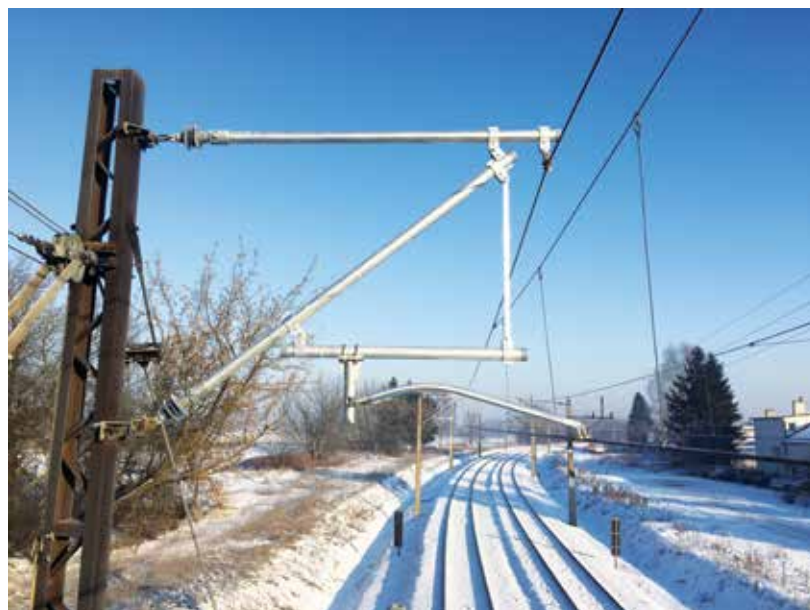
Fot. 8. Systemy podwieszenia sieci jezdnej firmy Galland SAS zainstalowane na linii 26 – odsuw do słupa
