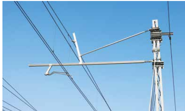
Fot. 3. Podwieszenie przelotowe na linii 273 – odsuwnie od słupa
