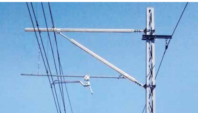
Fot. 4. Podwieszenie środkowe na linii 273
