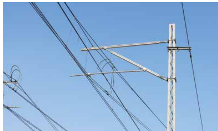
Fot. 5. Podwieszenie krzyżowe na linii 273
