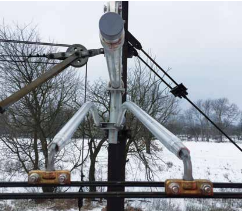
Fot. 9. System podwieszni i ramiona odciagowe firmy Galland SAS zainstalowane na stupie kotwowym
