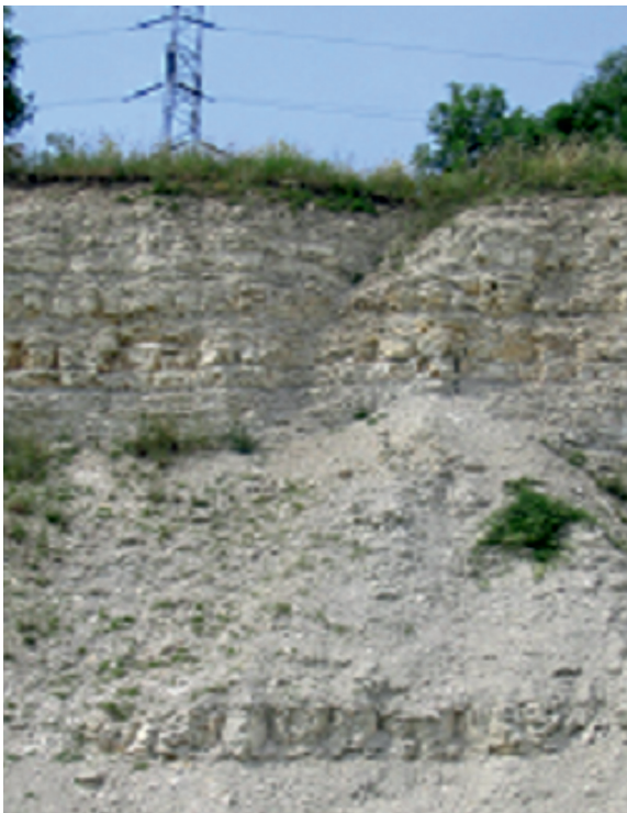
Rys. 10. Procesy erozyjne w pobliżu ul. Luboszyckiej Fig. 10. Erosion processes near the Luboszycka street
