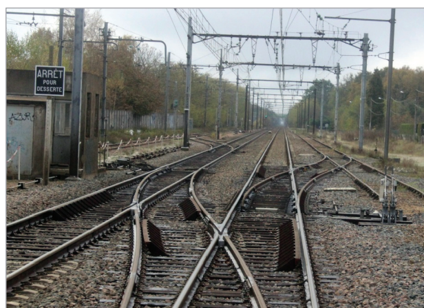
Rys. 1. Rozjazdy na odcinku Les Aubrais – Vierzon [fot. A. Massel]
