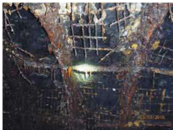
Rys. 1. Wyrobisko górnicze w obudowie ŁP ze stalowymi siatkami zniszczonymi w wyniku korozji materiału
