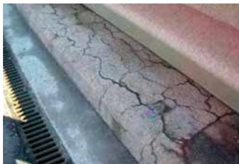
Rys. 1. Korozja alkaliczna kruszywa – przykłady destrukcji betonu [10]
