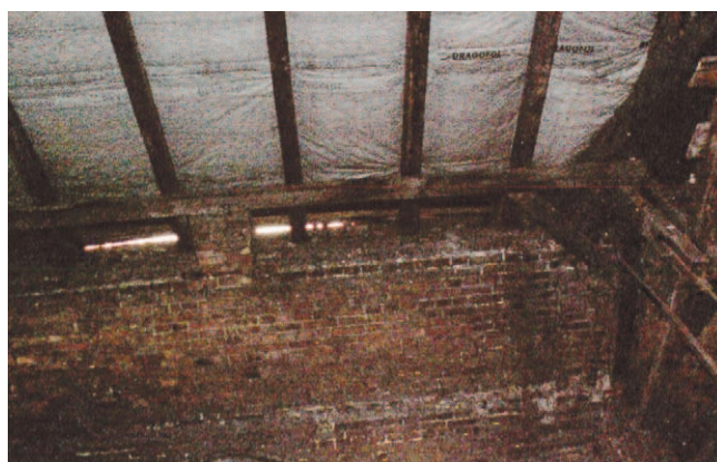
Rys. 6. Wyboczenie murłaty nad ścianą transeptu
