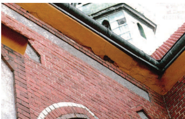
Rys. 5. Uszkodzenia gzymsu nad ścianą prezbiterium
