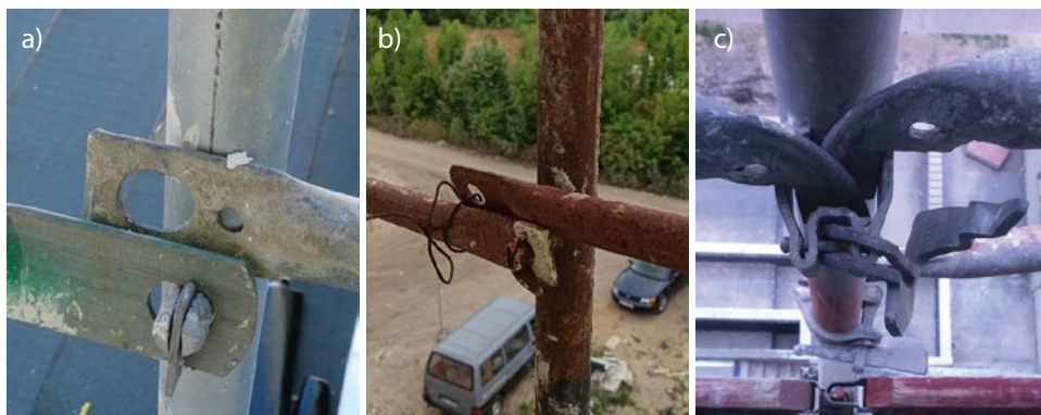
Rys. 3. Niewłaściwy montaż poręczy: a) poręcz niezabezpieczona, b) poręcz „na drut”, c) zniszczona blokada poręczy
