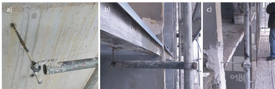
Rys. 4. Niewłaściwe kotwienie: a) łącznik kotwiący równoległy do elewacji, b) kotwa równoległa do elewacji, c) kotwienie w połowie wysokości ramy
