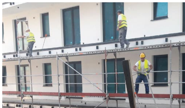
Rys. 8. Demontaż rusztowania prowadzony bez jakichkolwiek zabezpieczeń przed upadkiem z wysokości
