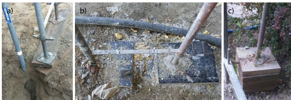
Rys. 1. Niewłaściwe posadowienie rusztowania: a) niewyprofilowane podłoże, b) niezależne podkłady pod każdą podstawką, c) wielopoziomowe podkłady
