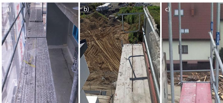
Rys. 2. Brak zabezpieczeń bocznych: a) w obrębie wnęk, b) w polu poza obrysem budynku, c) rama skrajna
