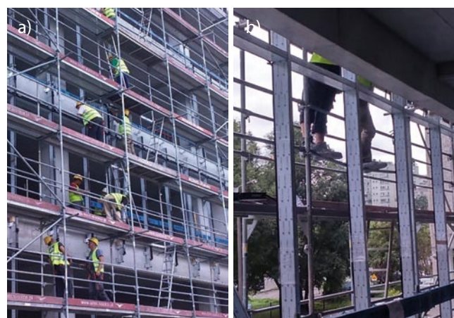
Rys. 6. Niewłaściwe użytkowanie rusztowań: a) wykonywanie robót w jednym pionie rusztowania na wszystkich poziomach jednocześnie, b) stawanie na poręczach wewnętrznych
