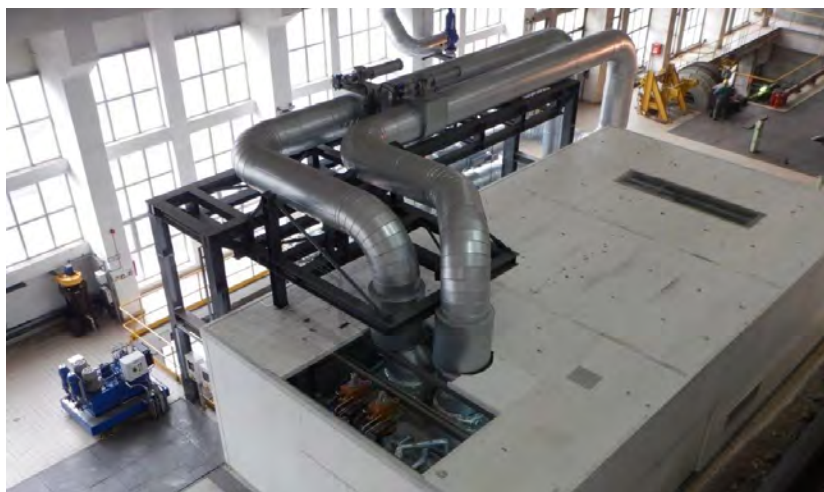
Zdj. 3. Wyprowadzenie rurociągów pary z turbiny do członu ciepłowniczego
