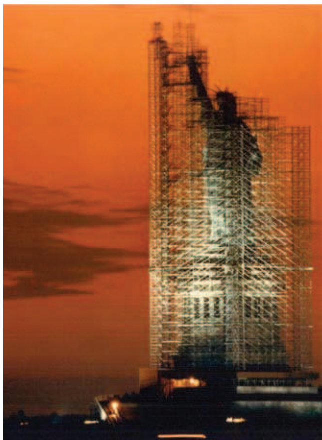
Rys. 18. Jedno z najstynniejszych i największych rusztowań na świecie „Wolność w rusztowaniu” wykonane przez firmę Universal Supply Buildings, Nowy Jork 1984. fot. z archiwum USB
