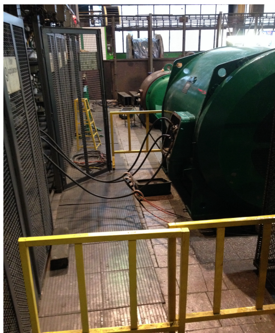
Rys. 1. Pomiar prądów fazowych w obwodach pierwotnych z wykorzystaniem elastycznych cewek Rogowskiego
