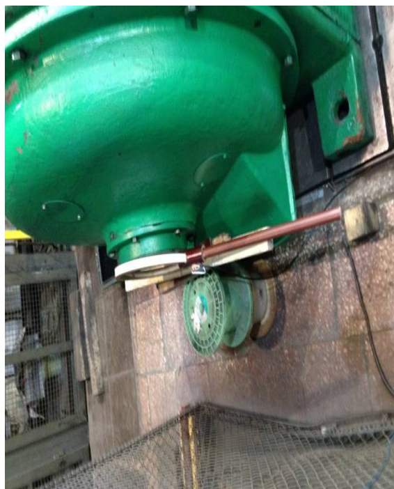
Rys. 5. Pomiar strumienia poosiowego dla silnika wysokonapięciowego dużej mocy
