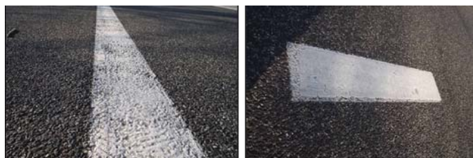
Fot. 6. Droga krajowa nr 94g; km 17+500 – 17+800 linia krawędziowa prawa; oznakowanie cienkowarstwowe na linii ciągłej oraz grubowarstwowe na linii przerywanej
