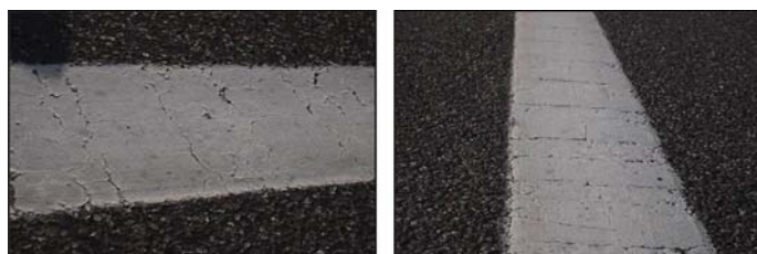
Fot. 7. Droga Krajowa nr 94g; km 18+400 – 18+700 linia krawędziowa prawa; oznakowanie grubowarstwowe odnowione farbą na linii ciągłej
