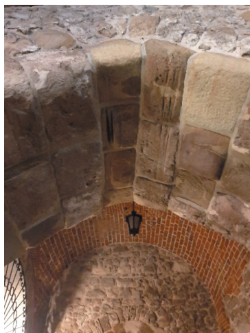
Fot. 1. Współczesne pozostałości po przejazdach tramwajów pod Bramą Floriańską w Krakowie (zdjęcie własne autora)
