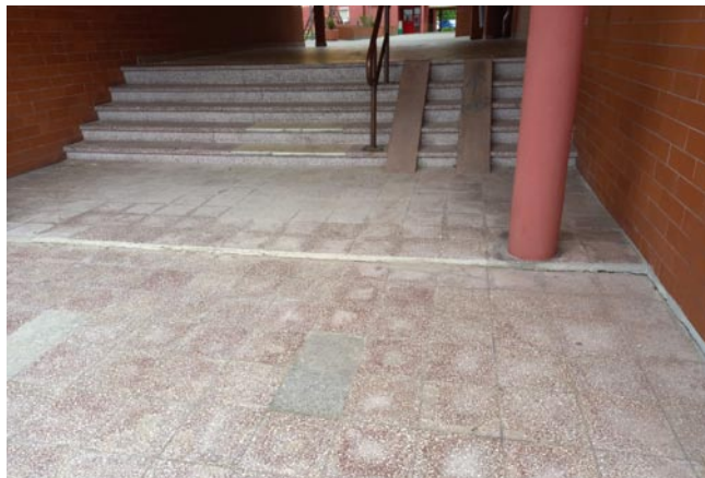
Rys. 1. Różnica wysokości na spoczniku schodów terenowych spowodowana osiadaniami
