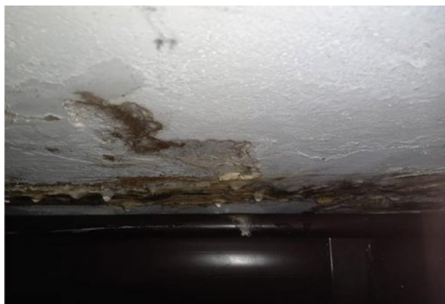
Rys. 8. Wycieki ze szczeliny dylatacyjnej podciągów po opadach deszczu
