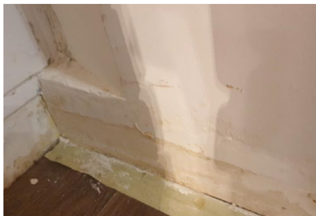
Rys. 11. Widoczne zawilgocenie i odspojenie tynków od strony salonu
