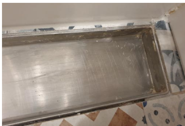
Rys. 13. Niewłaściwie wykonany odpływ liniowy w kabinie prysznicowej
