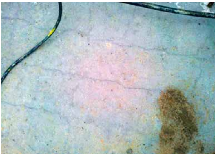
Rys. 9. Zarysowania pochodzące od osiadania plastycznego mieszanki betonowej
