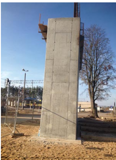
Rys. 1. Miejsce wypadku, zdjęcie zrobione dwa dni po zdarzeniu (źródło: zdjęcie własne)
