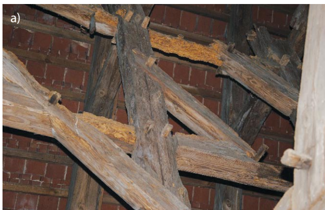
Rys. 6. Skorodowane elementy ścianki stolcowo-ryglowej
