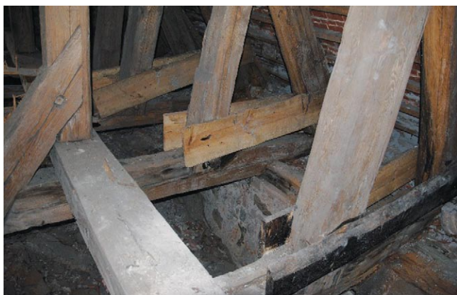
Rys. 11. Skorodowane końcówki belek więzarych wtórnie wzmocnione nadbitkami z desek
