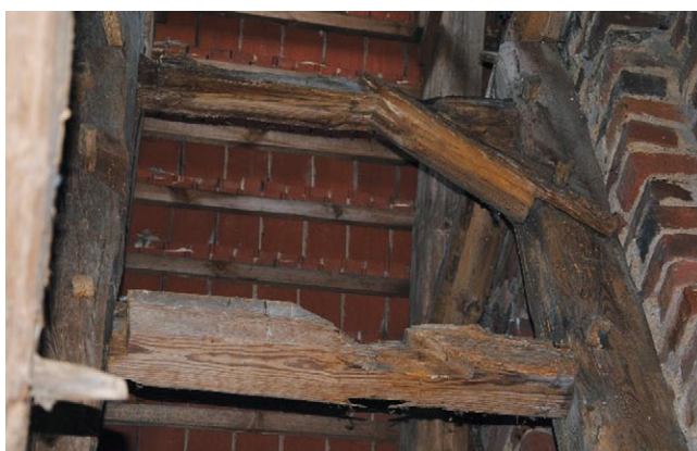
Rys. 8. Rozszczerzone połączenia elementów ścianki stolcowo-ryglowej
