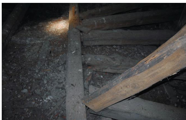
Rys. 14. Rozszczepione połączenia belek więzarych nad częścią prezbiterialną
