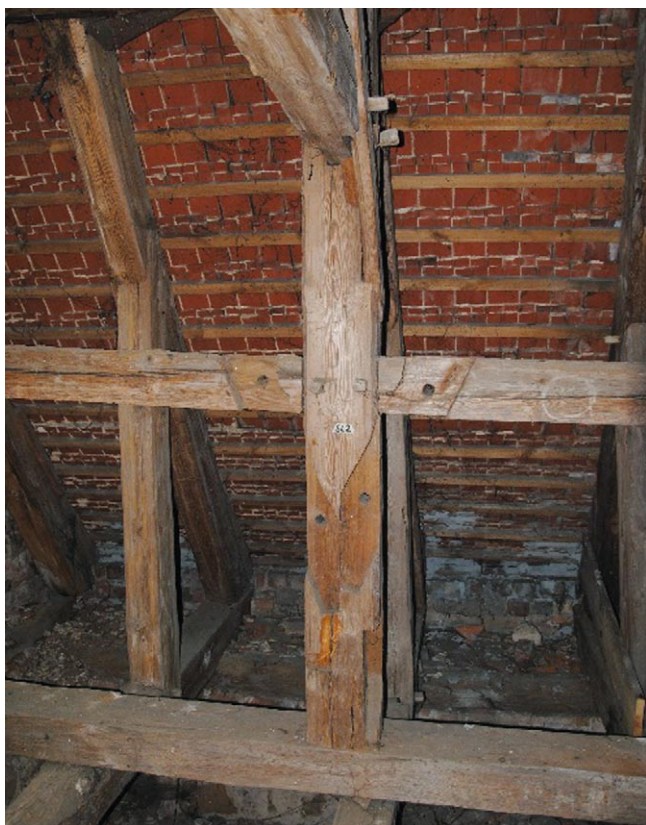
Rys. 9. Miejsca po usuniętych zastrzałach
