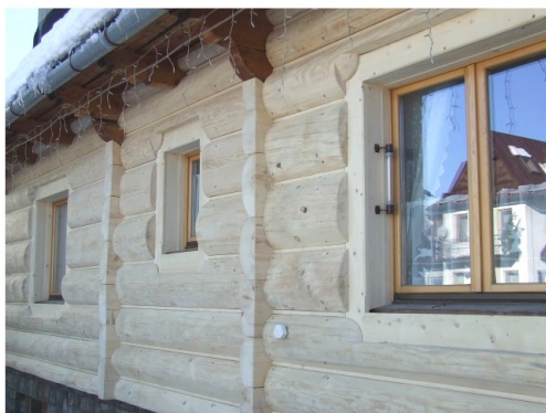
Ryc. 6. Ślepe węgly w okładzinie docieplonego drewnianego domu (fot. J. Łaś)
