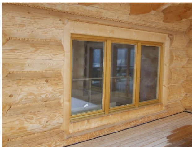
Ryc. 13. Współczesne okno osadzone w drewnianej ramie wbudowanej w zręb i ujętej w tzw. uszy (fot. J. Łaś)
