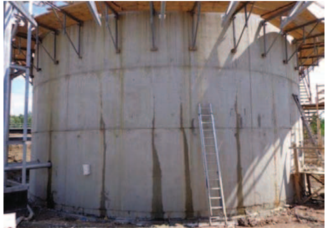
Rys. 2. Przekieki na ścianie zbiornika WKF przy słupie cieczy 5,5 m
