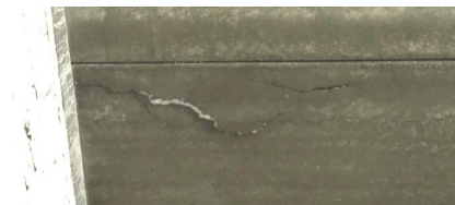
Rys. 5. Uszkodzenia płyt stropowych spowodowane przez wodę zamarzającą w kanałach [archiwum autorów]
