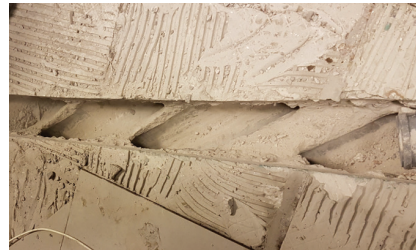
Rys. 6. Uszkodzenia stropu – bruzda w poprzek kilku płyt strunobetonowych [archiwum autorów]
