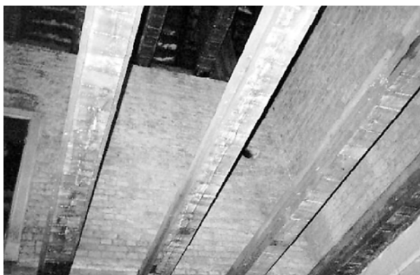
Ryc. 4. Odślonięte belki stropu drewnianego nad salą I piętra Fig. 4. Uncovered timber floor beams over 1 st floor
