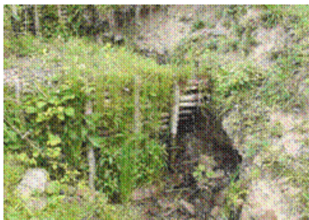
Рис. 5. Общий вид барража, заполненного эрозированными частицами (30 июля 2010 года)
