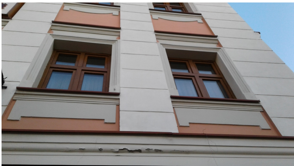
Rys. 6. Uszkodzony gzyms, fot. autor, Luty 2017
