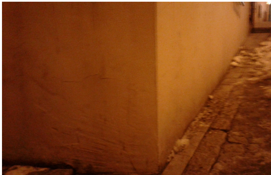
Rys. 8. Nieprawidłowe uzupełnienie skorodowanego tynku, fot. autor, Luty 2017
