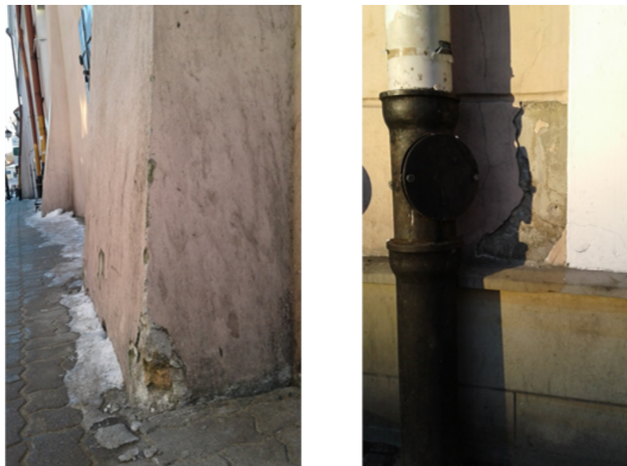
Rys. 4. Korozja tynku, fot. autor, Luty 2017
