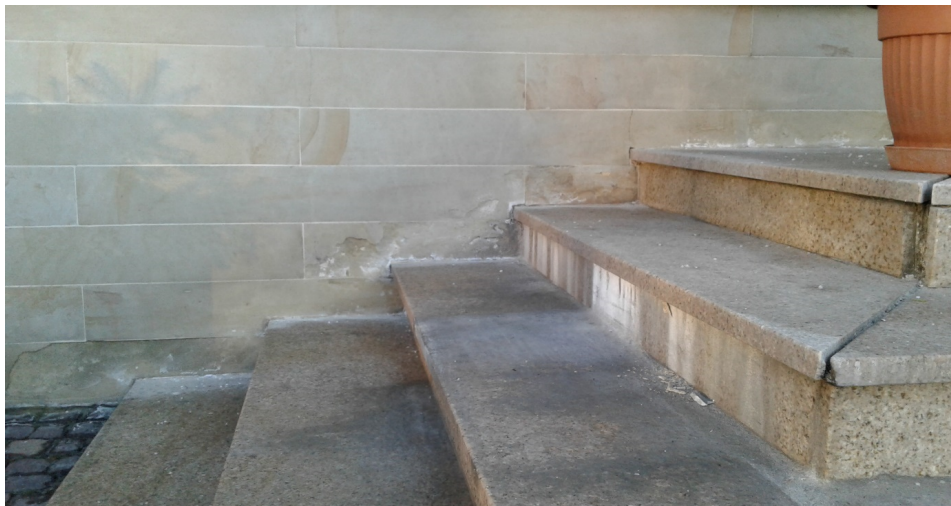
Rys. 5. Korozja cokółu, fot. autor, Luty 2017
