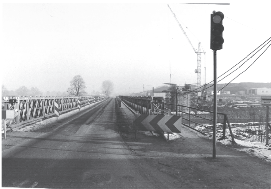
Rys. 1. Konstrukcja MS-54 wykorzystana do budowy mostu na Odrze (dł. 140 m) w ciągu drogi krajowej nr 936 w Krzyżanowicach, po powodzi w 1997 r. (widoczne ograniczenie szerokości jezdni) [4]
