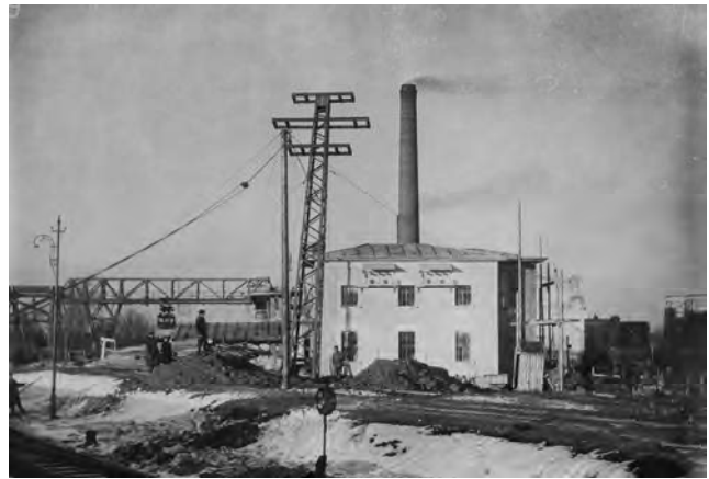
Rys. 3. Budowa napowietrznej linii przesyłowej 30 kV z Elektrowni Lwowskiej do Karaczynowa, oryginał w Muzeum Niepodległości w Warszawie, nr inw. F16085
