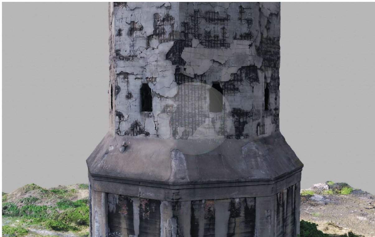
Rys. 8. Widok szczegółowy fragmentu ściany wieży ciśnień Uthemann – model 3D Fig. 8. An example of a heavily damaged wall of the Uthemann pressure tower - 3D model
