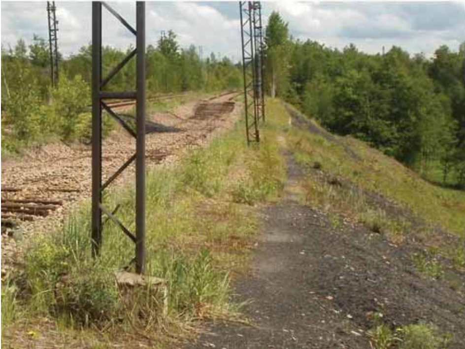
Fot. 1. Osuwisko w rejonie przepustu na rzece Bierawka
