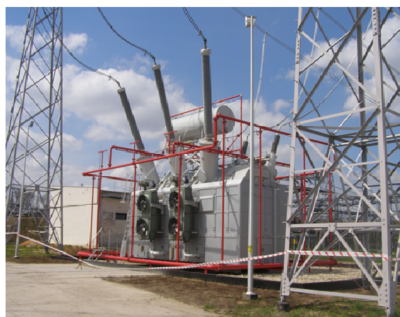
Rys. 9. Transformator o parametrach znamionowych 250 MVA, 400 kV z izolatorami suchymi typu ERIP
