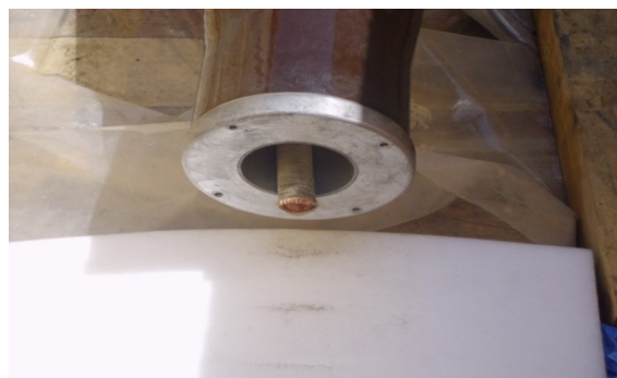
Rys. 5. Widok pierścieni aluminiowych (3) izolatora fazy B1 i izolatora fazy C1
