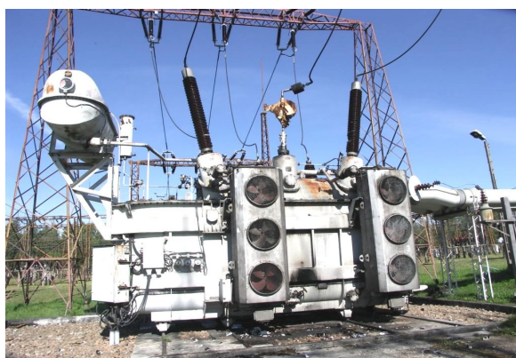
Rys. 8. Uszkodzony w wyniku eksplozji izolator przepustowy 220 kV fazy A1 w transformatorze o mocy znamionowej 160 MVA
