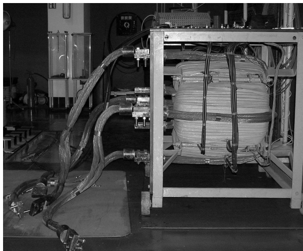
Rys. 11. Transformator wielkopoprądowy, ZWAR Warszawa, 1975 r., U_2 = 7,5 \text{ V} , I_2 = 7 \text{ kA} do prób kriokabli
