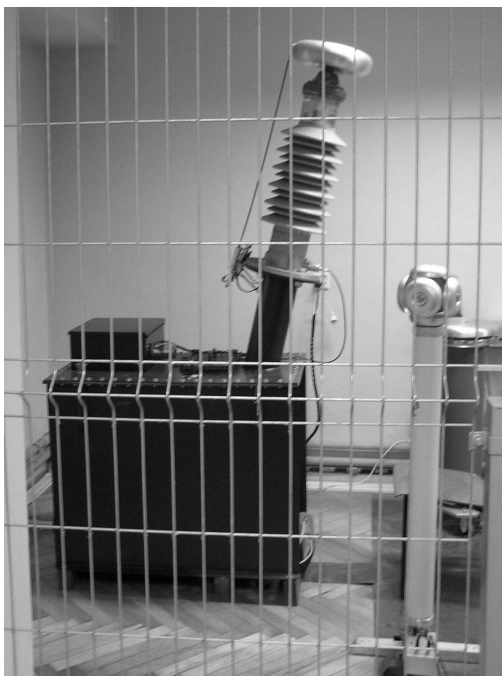
Rys. 15. Transformator Phenix na stanowisku do pomiaru wyładowań niezupełnych z kondensatorem Doble Lemke
