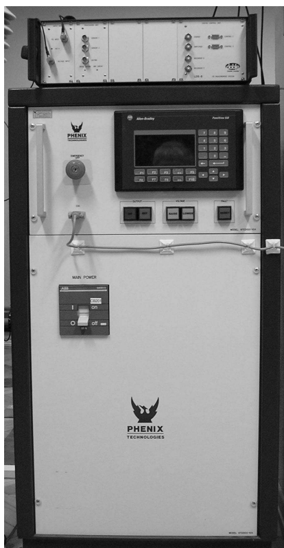
Rys. 16. Panel sterujący transformatora Phenix i system Doble Lemke z 2012 r. do pomiaru wyładowań niezupełnych
