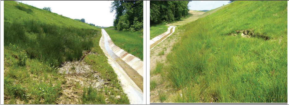
Rys. 2. Przyptyw wody do podnóża nasypu z osuwiskiem powierzchniowym
