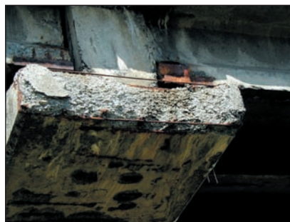
Fot. 3 Uszkodzony oczep podpory mostowej
