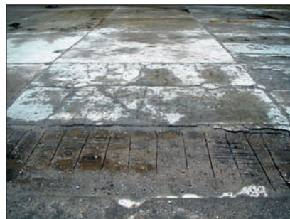
Fot. 2 Zniszczona otulina w płycie zbrojonej
