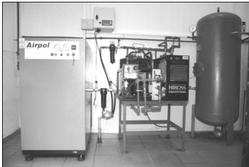
Rysunek 7. Widok rzeczywisty instalacji sprężonego powietrza w Zakładzie MSiTŻ Politechniki Poznańskiej
