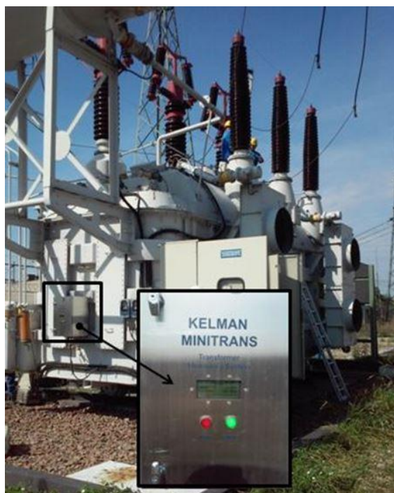
Rys. 2. Przykład instalacji systemu monitoringu zawartości wody oraz gazów w oleju na autotransformatorze 160 MVA
