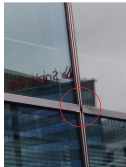
Fot. 5. Uszkodzenie listew dociskowych
