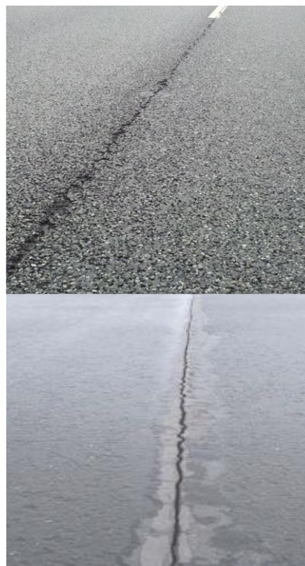
Rys. 1. Podłużne spękania nawierzchni drogowej w strefie spoin podłużnych (GDDP, 2002)
