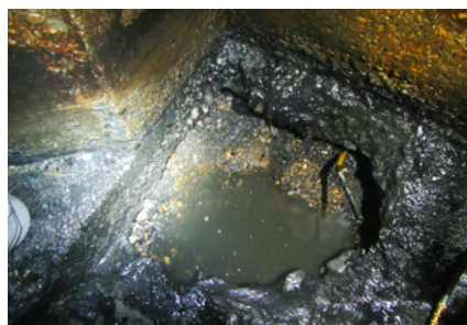
Ryc. 19. Brakująca podłoga komory
