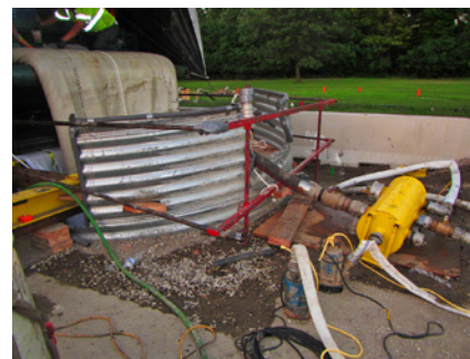
Ryc. 9. Wprowadzania rękawa do kolektora o wymiarach 1,75 x 1,75 m przez szyb o długości 335 m
