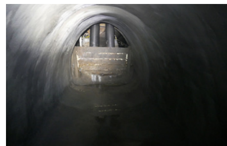
Ryc. 4. Przepompownia ścieków w komorze nr 1
