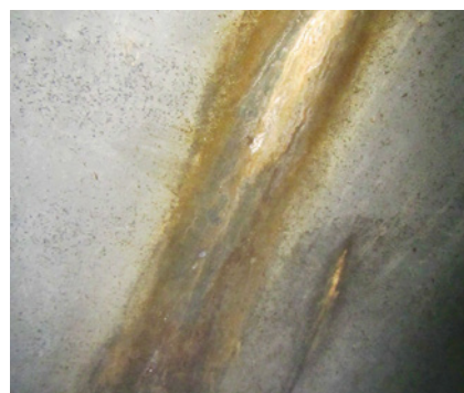
Ryc. 16. Po położeniu betonu geopolimerowego zaobserwowano pęknięcia o wielkości włosa oraz infiltrację
