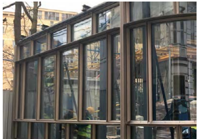
Rys. 11. Budynek CT SMYK w Warszawie jako przykład fasady odwarzalnej – źródło: archiwum własne autora i konsultanta
