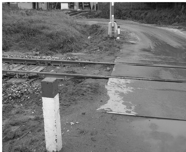
Rys. 4. Brak odwodnienia rejonu przejazdu
