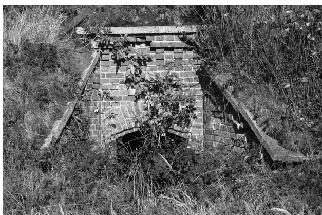
Rys. 2. Niedrożny przepust pod torami
