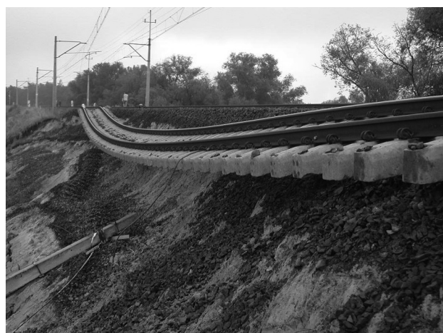
Rys. 6. Osuwisko nasypu obejmujące zasięgiem jeden tor
