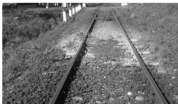
Rys. 5. Wychłapki w torze spowodowane brakiem warstwy ochronnej torowiska
