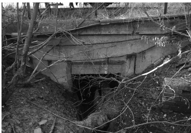
Rys. 3. Zniszczony przepust pod torami
