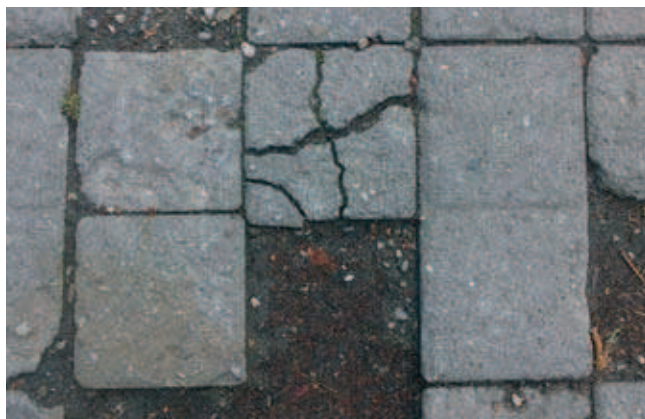
Rys. 6. Uszkodzenia brukowych kostek betonowych związane z oddziaływaniem czynników eksploatacyjnych (fot. Paweł Kossakowski)
