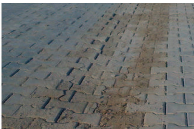
Rys. 9. Podłużne przełomy nawierzchni z kostki betonowej na granicy stref odsnieżanych i nieodsnieżanych (fot. Paweł Kossakowski)
