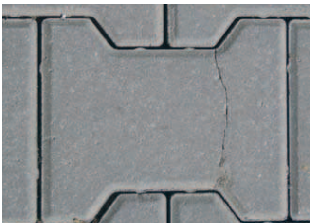
Rys. 10. Pęknięcie kostki betonowej (fot. Paweł Kossakowski)
