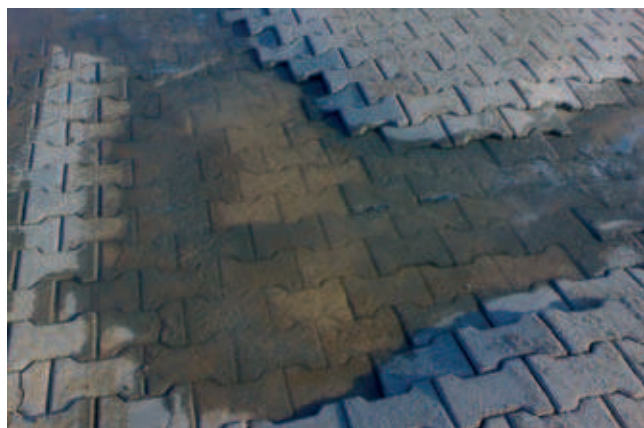
Rys. 7. Uszkodzenie nawierzchni brukowej z kostki betonowej na skutek oddziaływania wody opadowej w okresie zimowym (fot. Paweł Kossakowski)
