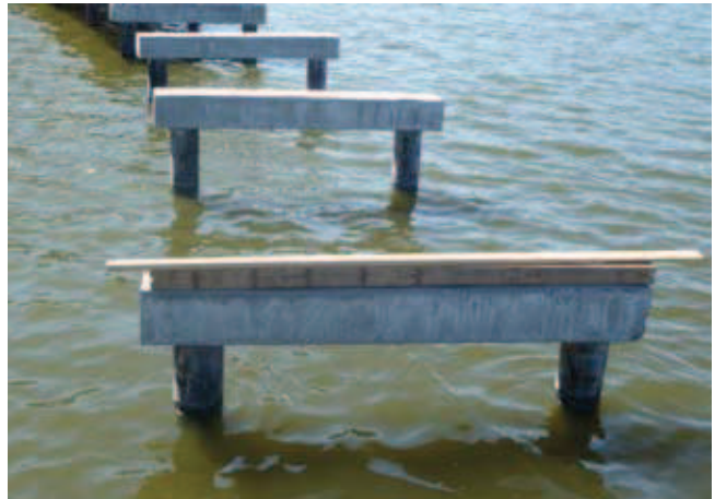
Rys. 3. Obserwowane osiadania pali podpory nr 18
