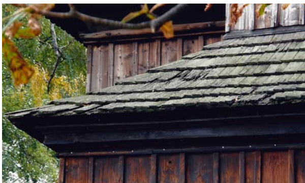
Ryc. 11. Zniszczone pokrycie dachu na kruchcie (narożnik pn.-zach), 2010 r.
