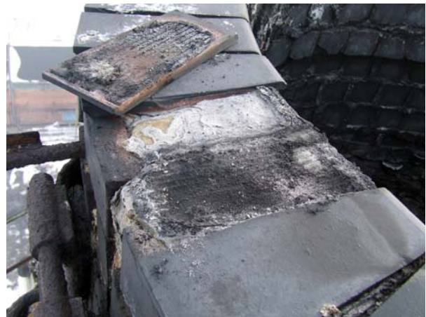
Ryc. 9, 10. Korozja płaszczu przy wylocie komina, odspojenia płytek klinkierowych Fig. 9, 10. Corrosion of chimney jacket at the chimney outlet, detachments of clinker tiles
