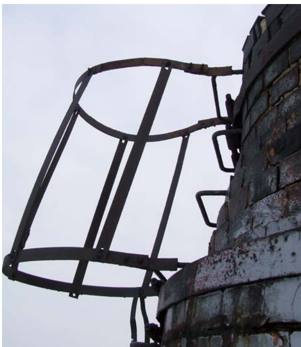
Ryc. 7, 8. Korozja klamer wyłazowych i płaszczu komina Fig. 7, 8. Corrosion of step irons and chimney jacket
