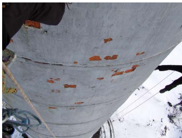
Ryc. 5. Pęknięcie pionowe kominia Fig. 5. Vertical chimney crack
