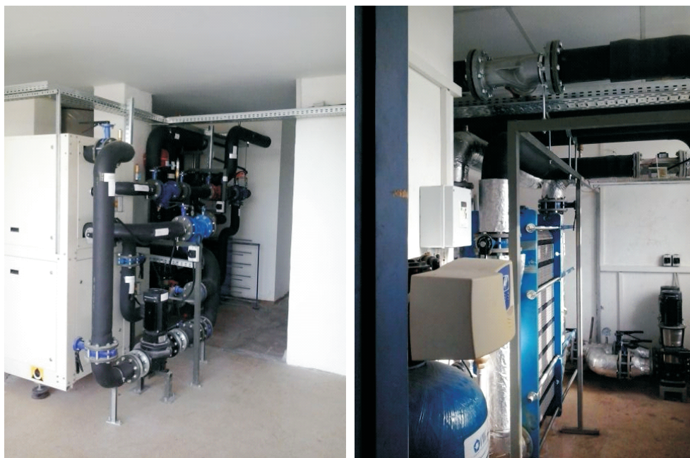
Fot. 2. Stacja pomp ciepła w Mórahalom (źródło: www.geothermalcommunities.eu )
