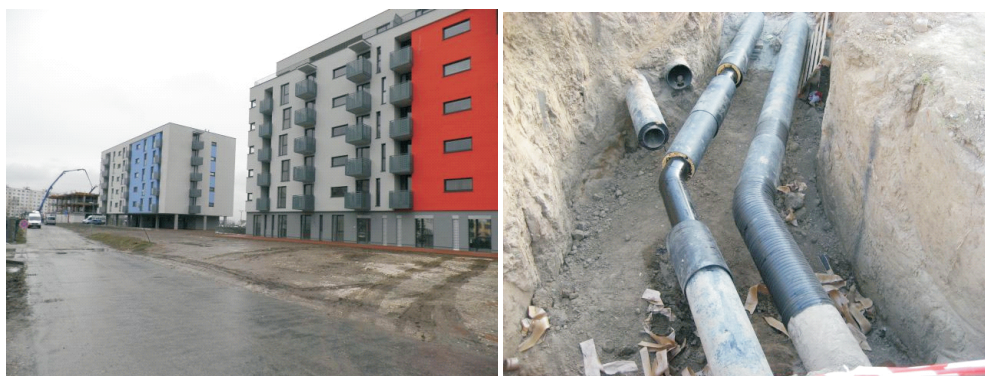
Fot. 4. Nowe budynki i rurociąg ciepłowniczy w Galancie (źródło: www.geothermalcommunities.eu )
