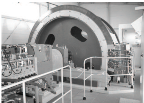
Rys. 6. Maszyna wyciągowa B-4300/DC-8m/s [źródło: własne]
