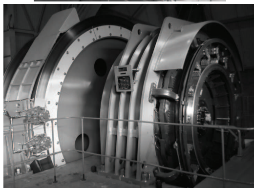
Rys. 4. Maszyna wyciągowa 2L-5000/2400 [źródło: własne]
