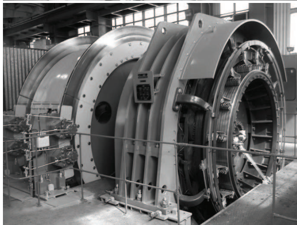
Rys. 2. Maszyna wyciągowa 4L-4000/3900 [źródło: własne]
