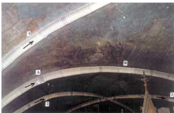
Fot. 4. Punkty załamania żeber sklepienia
