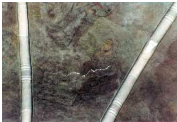
Fot. 10. Zmiażdżenie części żebra w punkcie 4 i przypowierzchniowego fragmentu sklepienia
