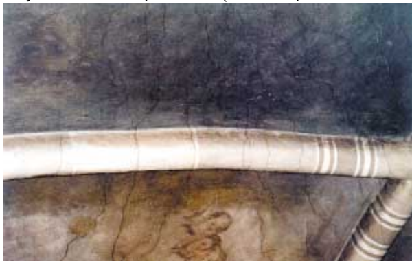
Fot. 6. Zarysowanie żebra przekątnego
