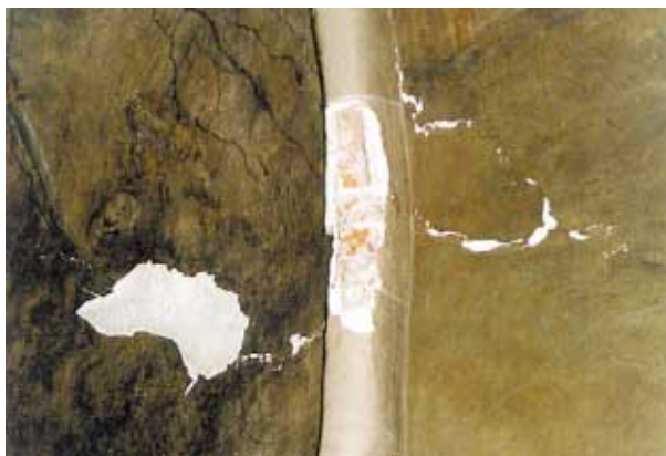
Fot. 9. Zmiażdżenie części żebra w punkcie 3 i przypowierzchniowych warstw sklepień
