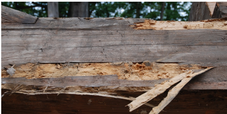
Ryc. 1. Charakterystyczny przykład zniszczonego elementu konstrukcji drewnianej przez drewnojady (fot. H. Melges)
