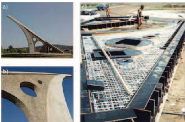
Rys. 10. Największy na świecie zegar słoneczny – Australia: a) widok całej konstrukcji, b) widok z dołu, c) ocynkowane zbrojenie w deskowaniu; [M4]
