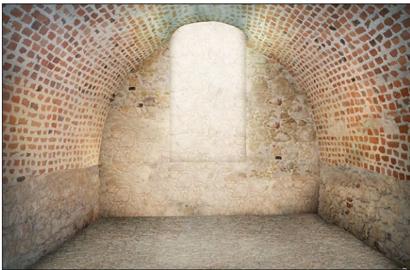
Ryc. 7, 8. Piwnice skrzydła wschodniego, łączącego dom Pęcherza z kurią Piotra Gerhardsdorfa, widok na ścianę wschodnią z oknem od ul. Jagiellońskiej. Stan obecny i wizja przeszłości; oprac. A. Kulig, J. Dziewoński.
