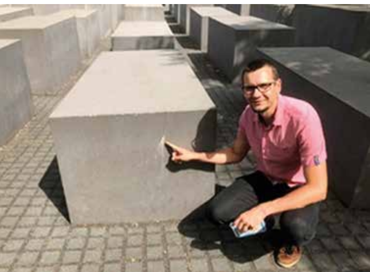
Fot. 5. Widok betonowych bloków tworzących Pomnik Pomordowanych Żydów Europy w Berlinie z symptomami prawdopodobnej reakcji alkalia-kruszywo (wysięki żelu, spękania) i wzmocnieniem obejmami z blachy
