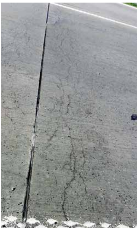
Fot. 3. Nawierzchnia betonowej drogi ze spękaniem z powodu reakcji alkalia-kruszywo
